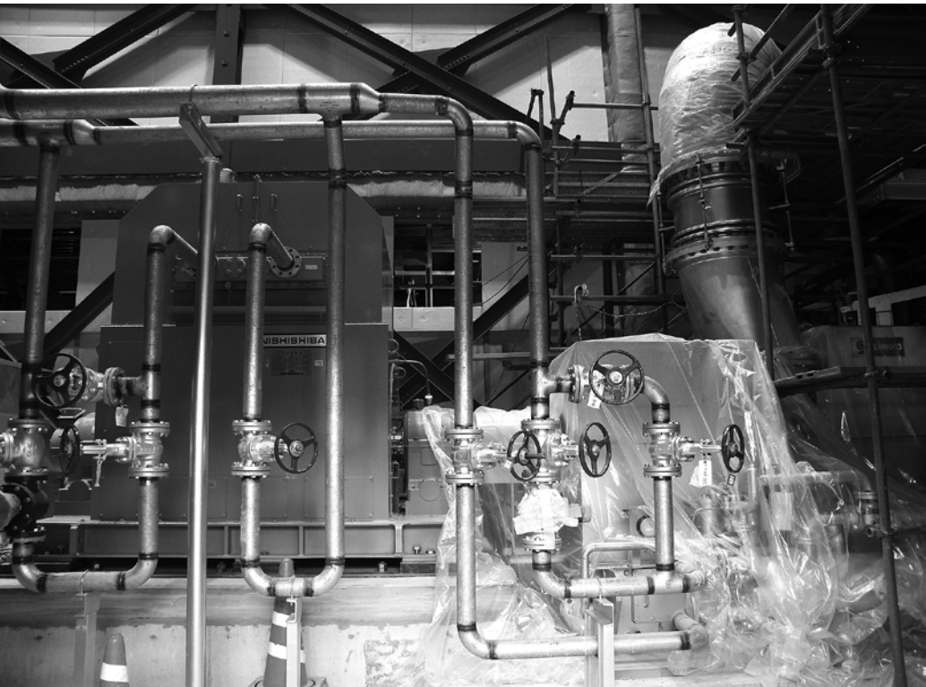
▲発電の要となる発電機とタービン
